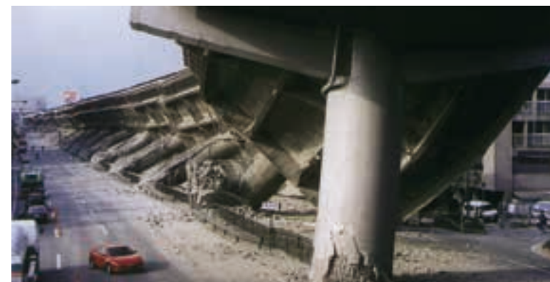
阪神・淡路大震災により倒壊した阪神高速道路
