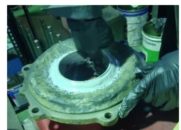
ポンプの穴開き補修
