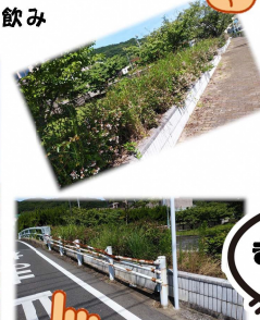
錆びて危険なガードレール
