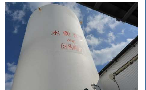
上) 郷ノ浦の水素貯蔵施設。洋上風力発電導入による更なる水素エネルギーの普及が期待される。
