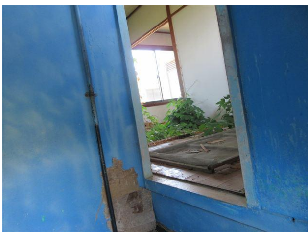
40号室内に草繁茂
