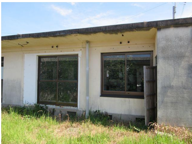
33号室内に草繁茂
