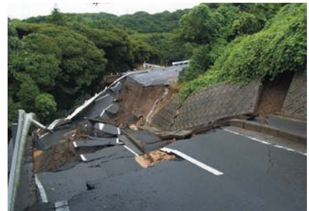
集中豪雨による被災状況（勝本町）
