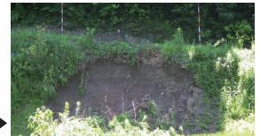
被災した市道▶
