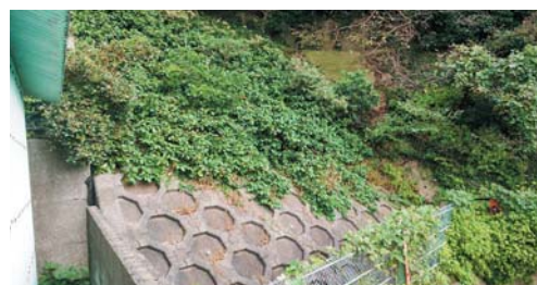
草木繁茂で崩壊の危険がある急傾斜
