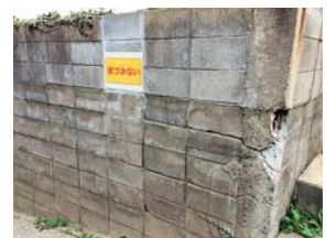
市内小学校ブロック塀
