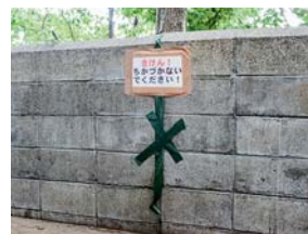
市内幼稚園のブロック塀
