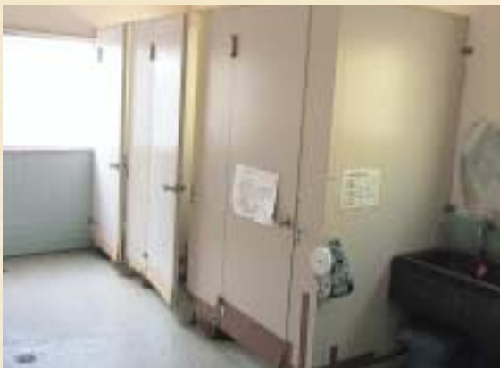
ガムテープで補修されたトイレ (えいか 盈科小学校)
