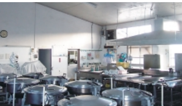
郷ノ浦町学校給食センター内の様子
