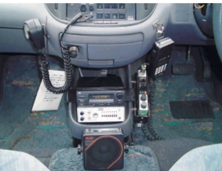
公用車に積載されている行政防災無線（移動系）
