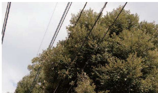
光ケーブル断線危険箇所
