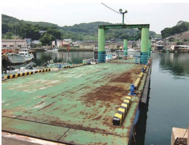
湯の本漁港の老朽化した浮棧橋
