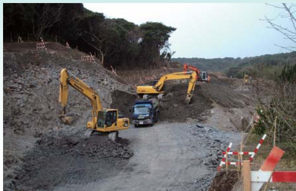
工事中の県道・新郷ノ浦港線(文化ホール～親和銀行へ通じる)
