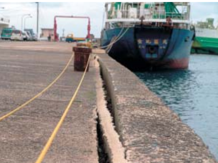
福岡県西方沖地震で被災した印通寺港（3月20日）
