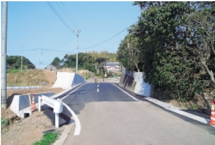
現在休止となっている市道勝利線（勝本町西戸触）
