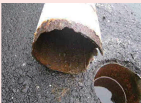
ポールの根腐れによる倒壊
