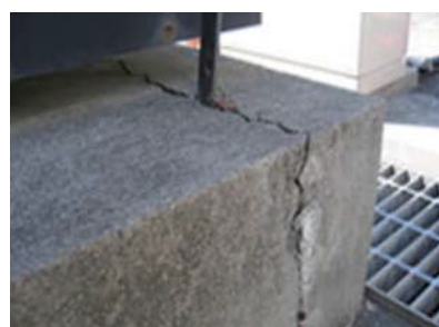
看板基礎のひび割れ
