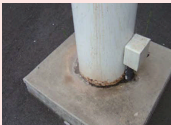
ポールの根元にサビが発生
