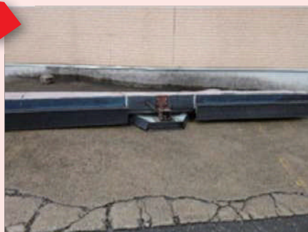
落下した欄間看板
