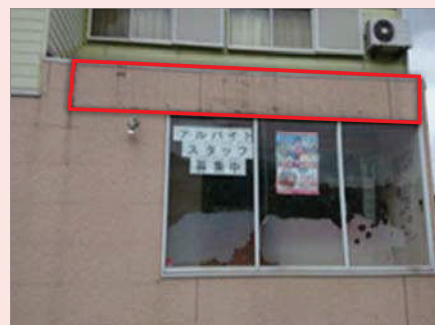
落下した後の壁面
