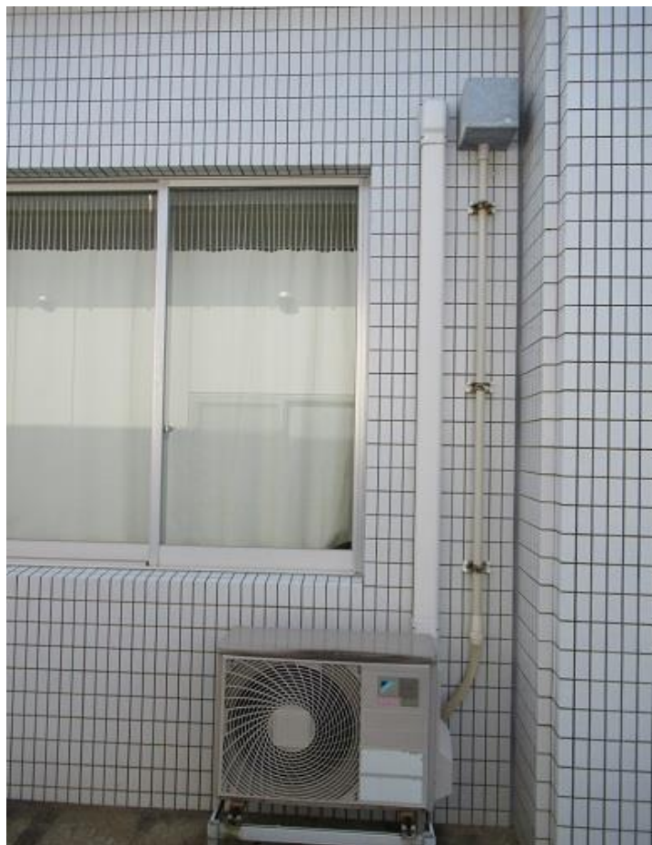
会議室室外機
