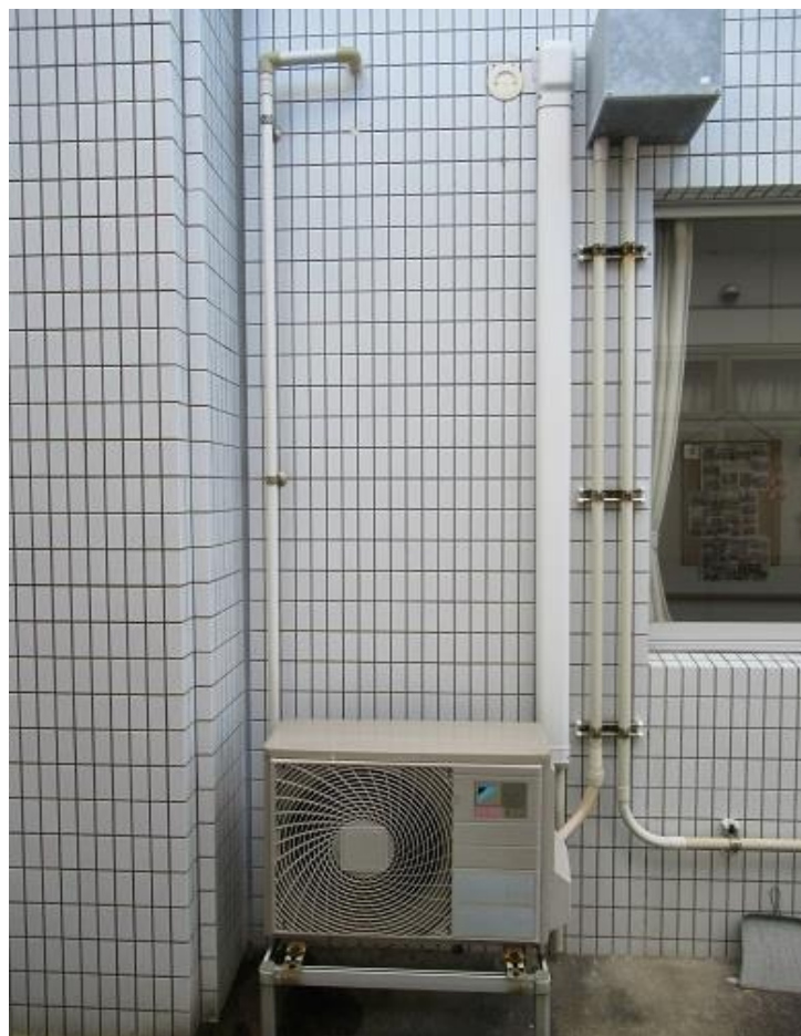
所長室室外機
