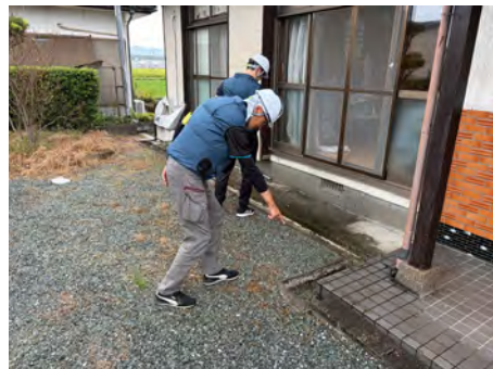
住家被害認定調査の様子
