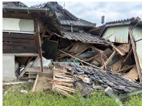
現地の被災状況
