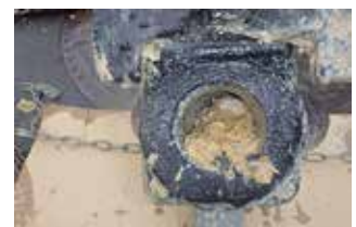
污水管閉塞の例
