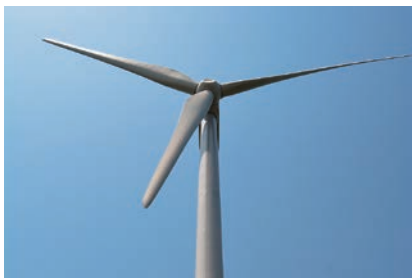
芦辺風力発電所2000kw竣工（5月）
